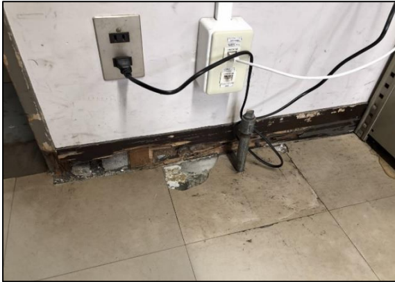
壁の剥離・亀裂
