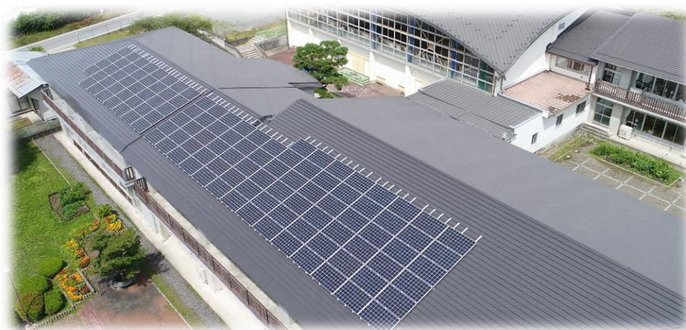
西部小学校に設置された太陽光発電設備
