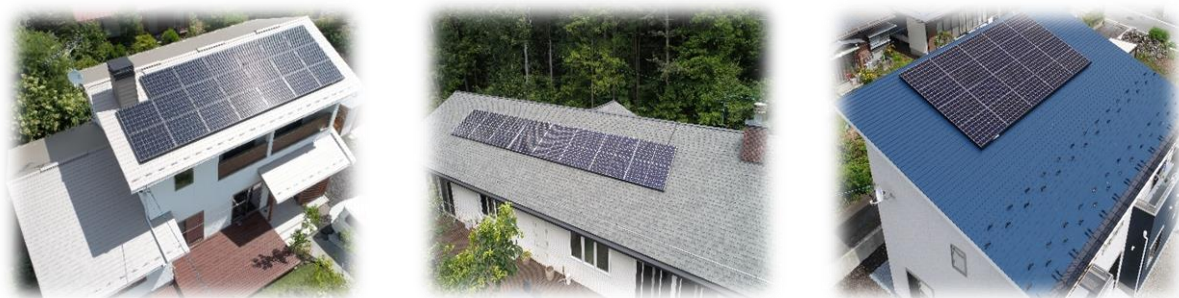
補助金を活用して設置された太陽光発電システム
