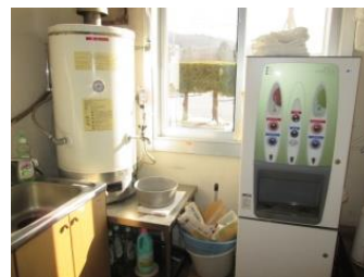
給湯器・給茶機の管理
