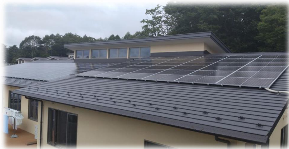
児童発達支援センターに設置された太陽光発電設備
