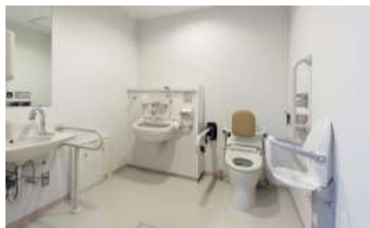
図 4-4-2: 多機能トイレ(立川市庁舎)
