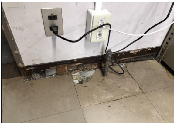
壁の剥離・亀裂
