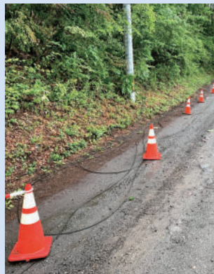
切れて落下した電線
