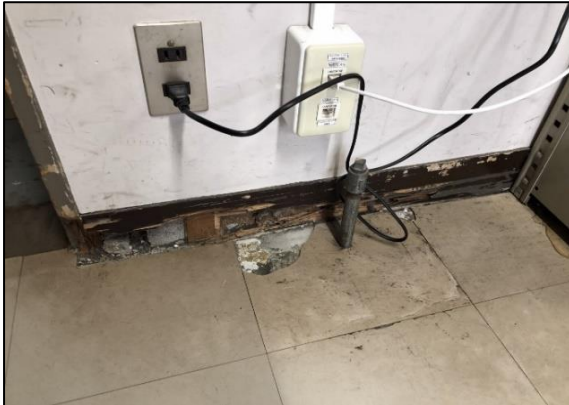
壁の剥離・亀裂
