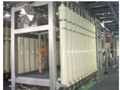
膜ろ過処理方式 浄水設備
